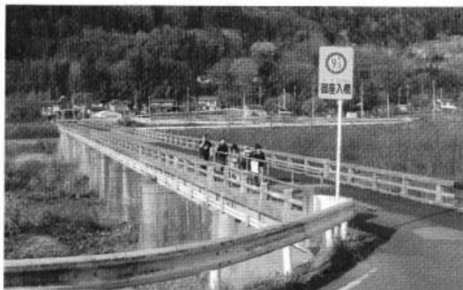
老朽化が進む御座入橋
