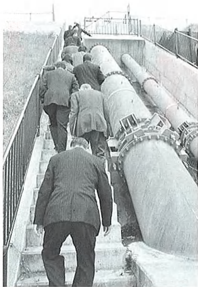
市営町川小水力発電所
