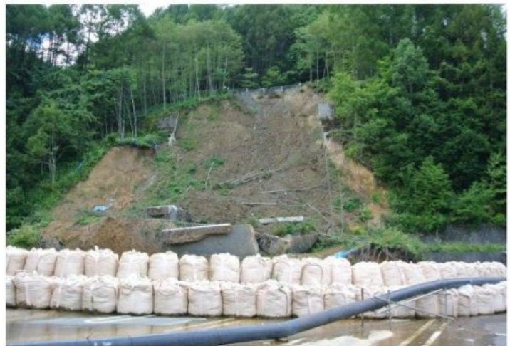
岩鞍の災害現場
