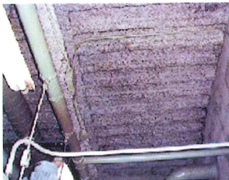
石綿含有吹付けロックウール
